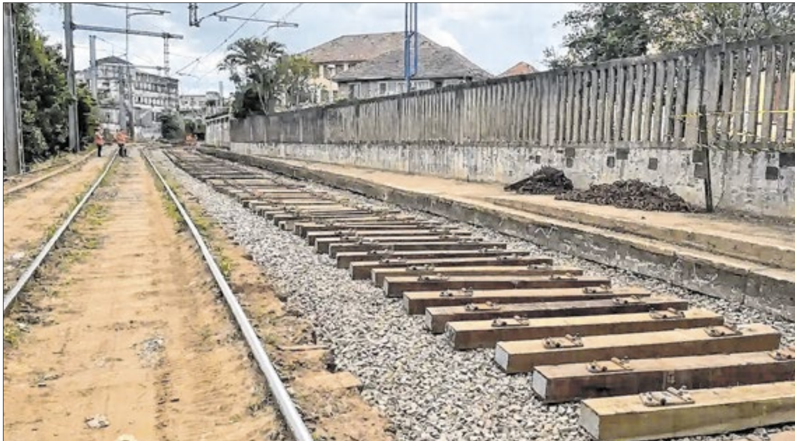
Dormentes de madeira são usados na sustentação dos trilhos; CPTM diz que fará fiscalização da origem e rastreabilidade do material fornecido pela empresa.
