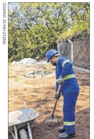
Sistema terá monitoramento remoto das elevatórias de esgoto
