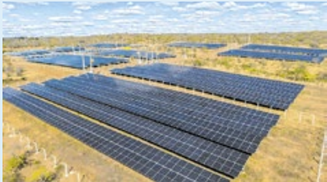
A matriz elétrica da Paraíba totaliza atualmente 2.573,02 MW
