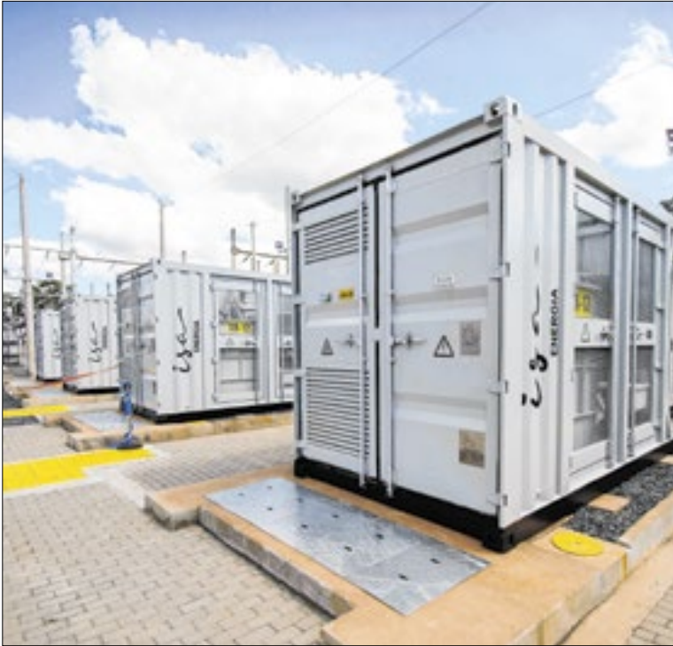
Instalação de armazenamento de energia da ISA Energia, em SP
