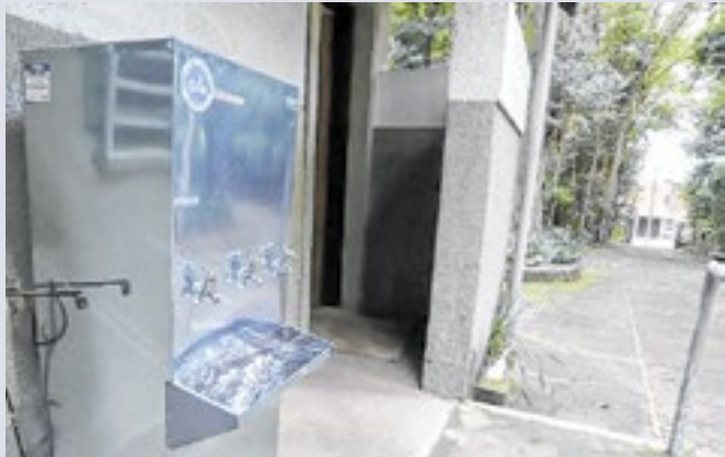
Bebedouro instalado no Bosque São José fica ao lado dos sanitários
