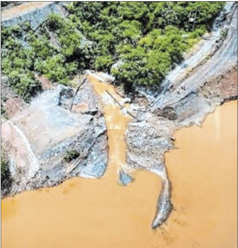
Área teve vazamentos em janeiro e agora foi liberada para operar parcialmente
