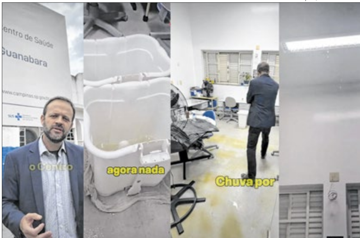
Vereador Wagner Romão fez uma vistoria no CS Guanabara e constata infiltrações e goteiras nas salas
