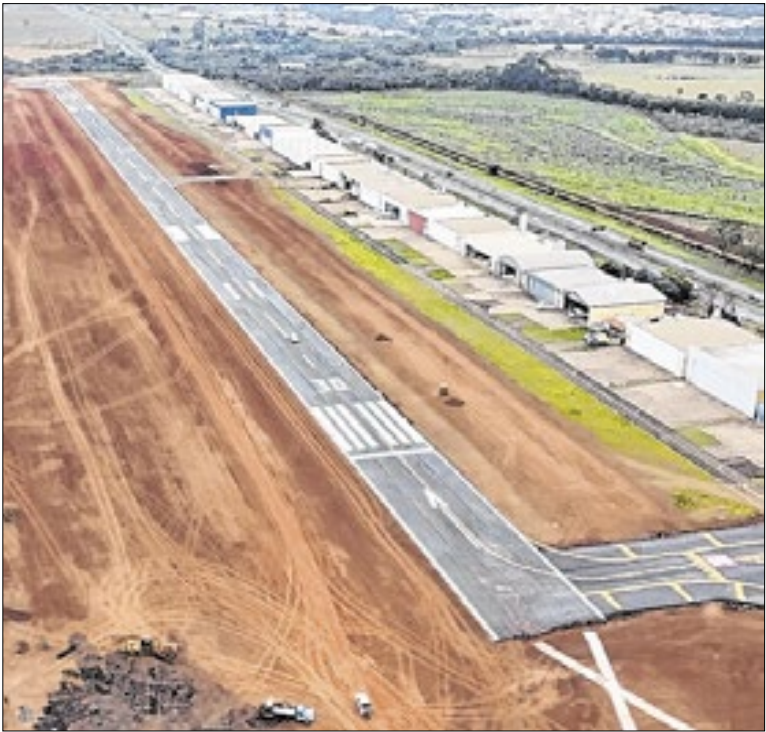
Projeto prevê novas áreas de segurança e equipamentos de navegação
