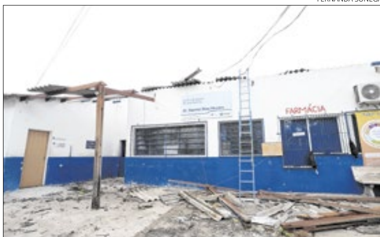
Unidade foi destelhada e houve entrada de água no prédio
