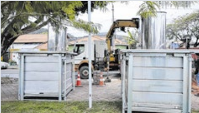
Lixeiras são instaladas na cidade e armazenam lixo no subsolo
