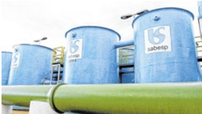
Estações de Tratamento de Água da Sabesp na Grande São Paulo
