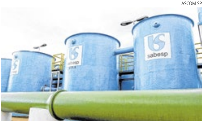
Estações de Tratamento de Água da Sabesp na Grande São Paulo
