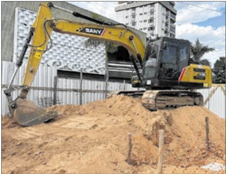
Unidade terá capacidade para tratar até 80 mil litros e operação automatizada
