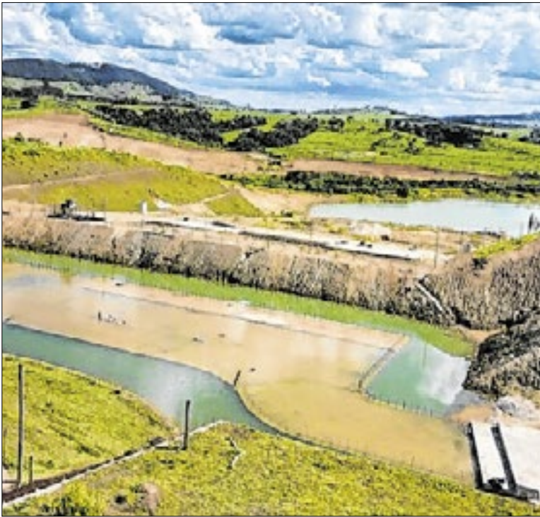
Pedreira e Duas Pontes terão capacidade conjunta de 85 bi de litros de água
