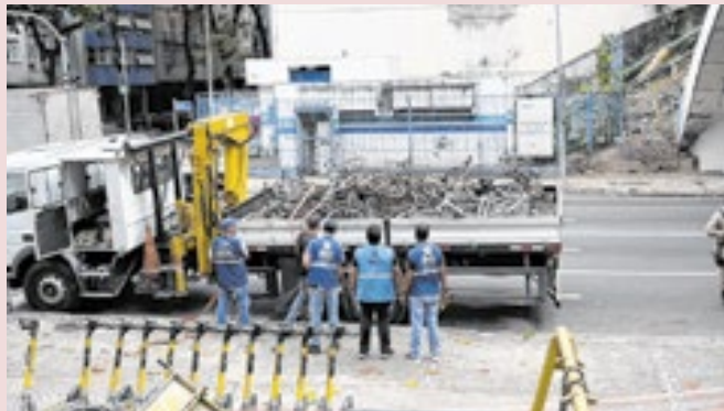
Estruturas ocupavam a escadaria e comprometiam circulação
