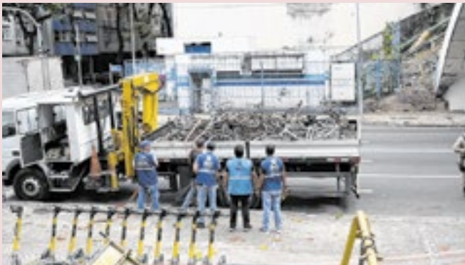
Estruturas ocupavam a escadaria e comprometiam circulação
