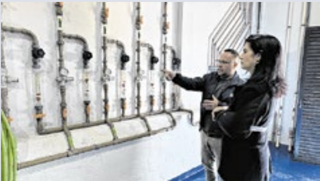
Produção do hipoclorito de sódio ocorre por reação eletroquímica
