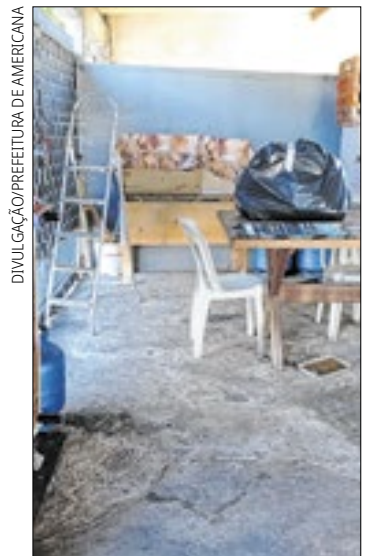
Local sem condições adequadas de higiene e salubridade
