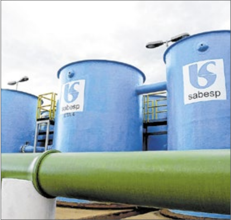
Estações de Tratamento de Água da Sabesp na Grande São Paulo
