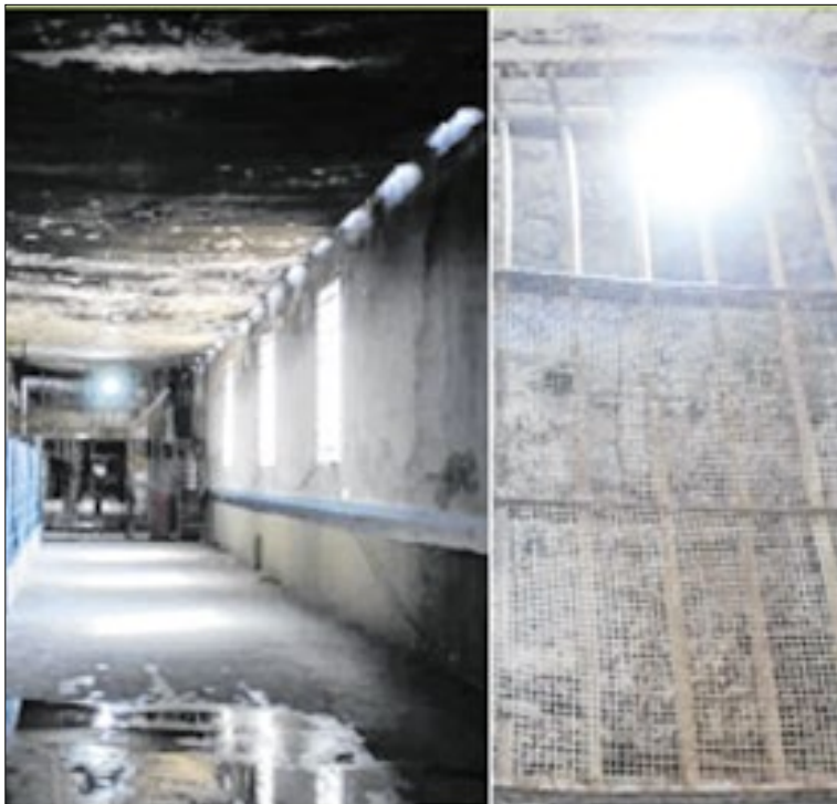
Relatório de inspeção da Defensoria Pública mostrou situação da penitenciária
