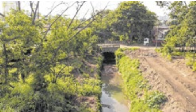
Trecho sofreu afundamento do solo e rompimento de tubos
