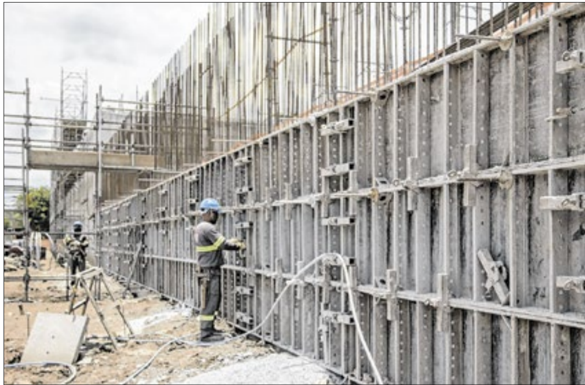
Maior capacidade da ETE Parque Novo Mundo (foto) vai beneficiar zonas norte e leste
