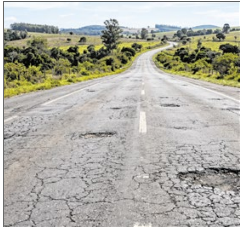
Laudo técnico aponta buracos, fissuras e trincas no pavimento
