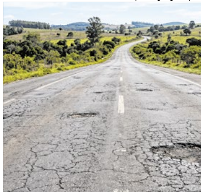
Laudo técnico aponta buracos, fissuras e trincas no pavimento
