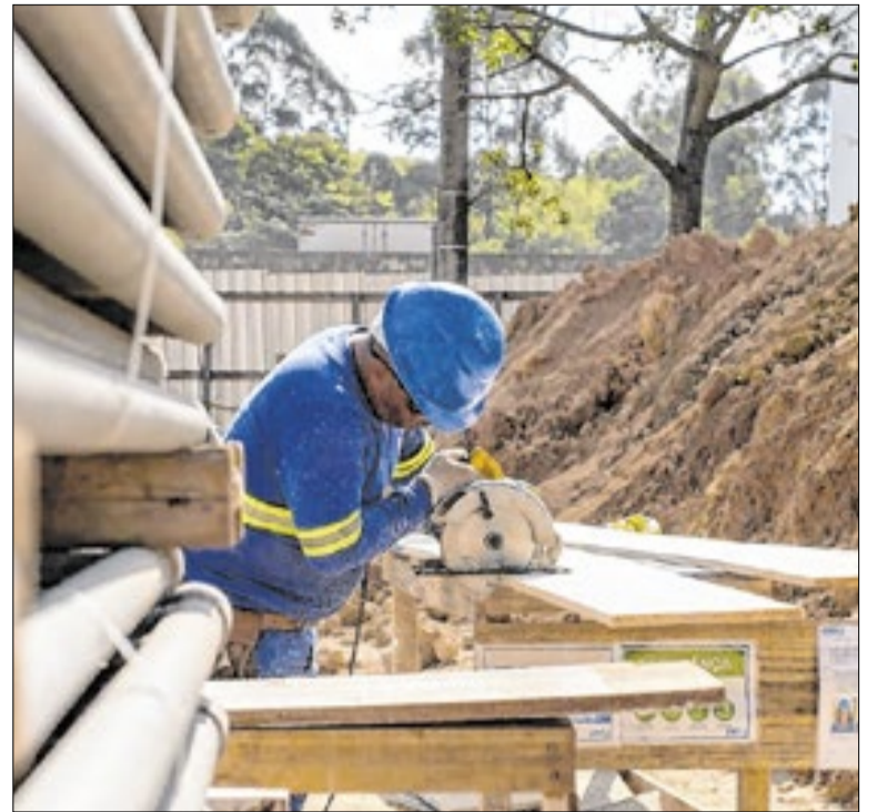
Estações ampliam o tratamento de esgoto na cidade
