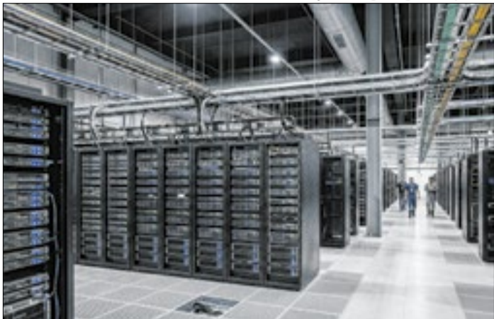
Data Center armazena dados e serviços na internet
