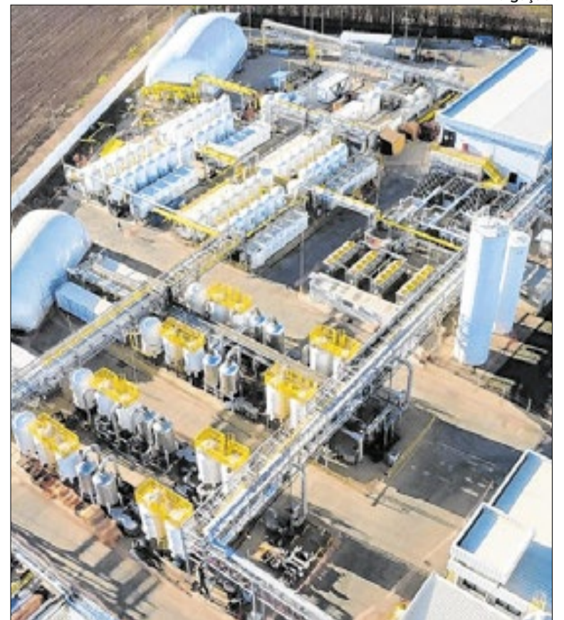
Usina de biometano na cidade de Paulínia
