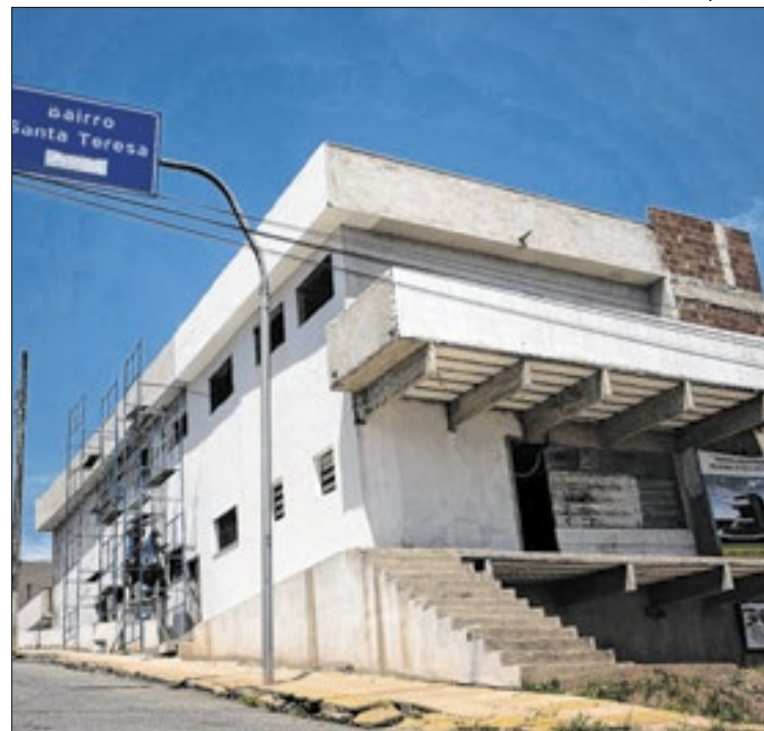
Empresa responsável abandonou obra da unidade no Rústico
