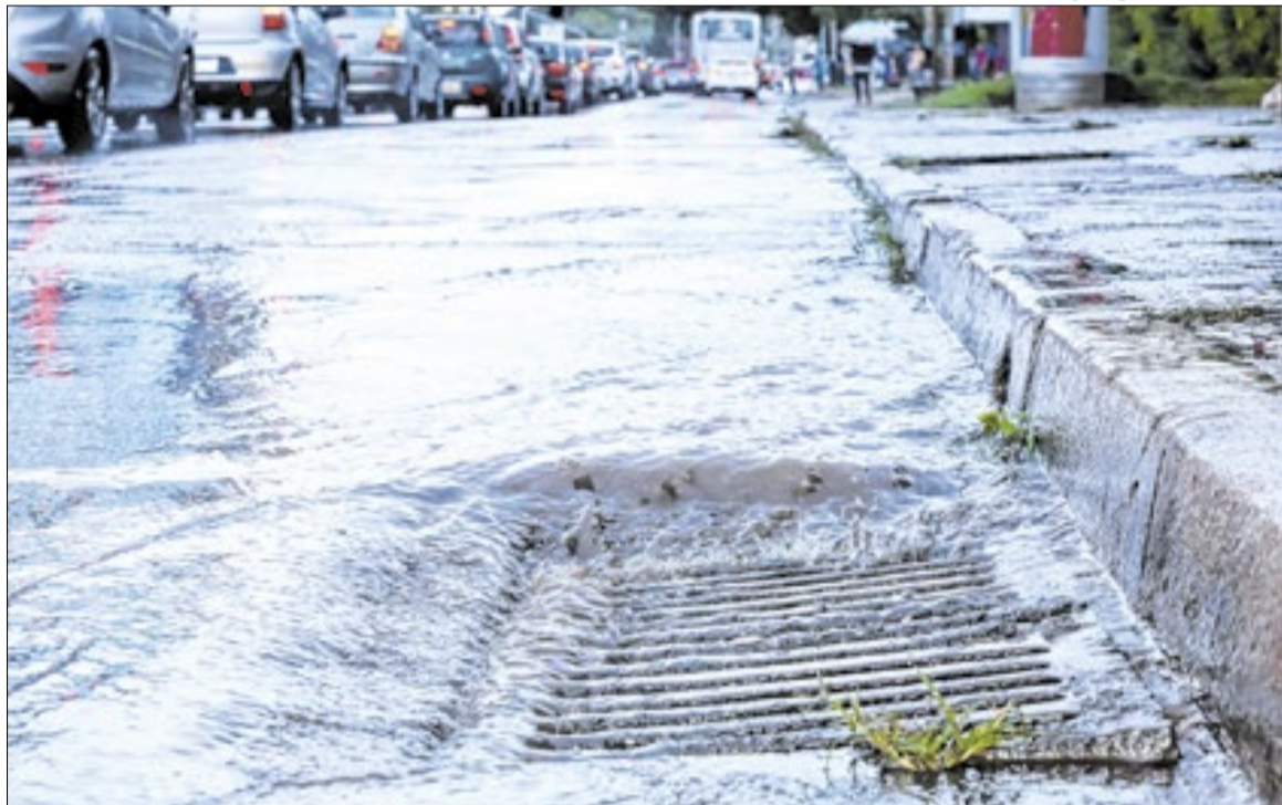
No período de chuvas, é comum o surgimento de poças d'água e extravasamento de esgoto
