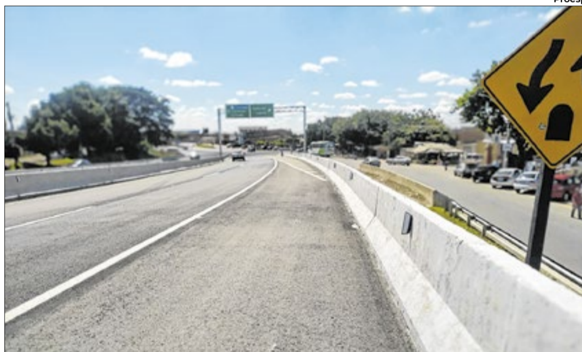
Obra foi inaugurada pelo governador sem sinalização de trânsito nas pistas
