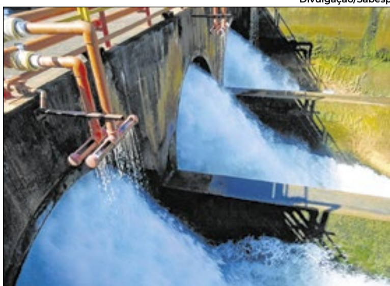
Unidades serão instaladas pela Região Metropolitana
