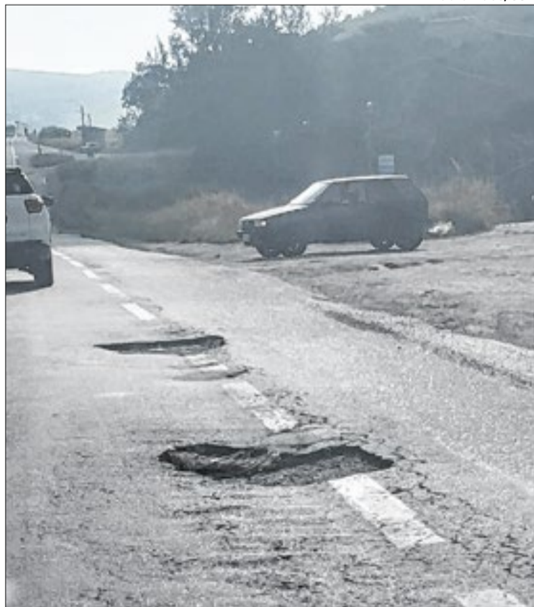
Trecho carece de manutenção e registra acidentes semanais
