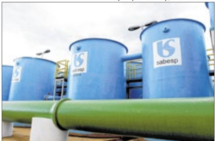
Estação de tratamento de água no Rio Jundiá
