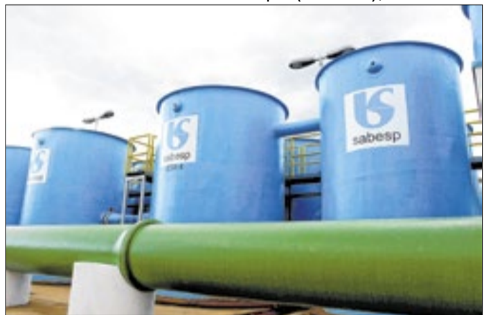
Estação de tratamento de água no Rio Jundiá
