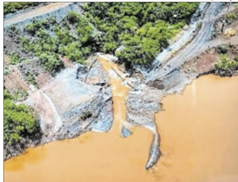
Área de armazenamento de água da Vale teve vazamentos
