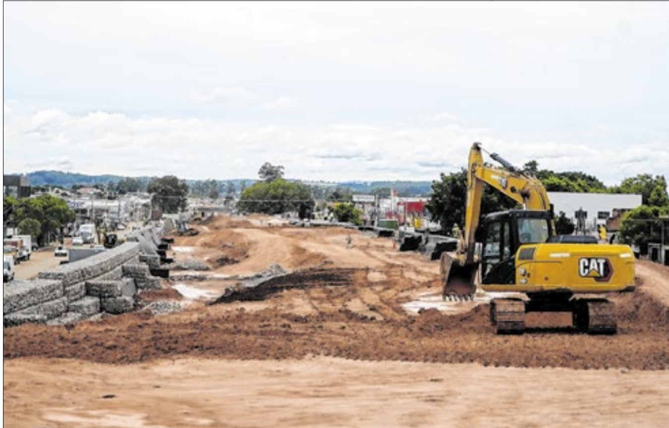
Rodovia Miguel Melhado (SP-324) em obras em janeiro de 2025; moradores ainda buscam casas
