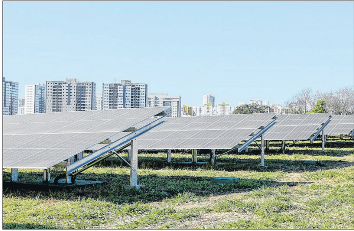
Usina pública de Águas Claras já abastece 80 prédios
