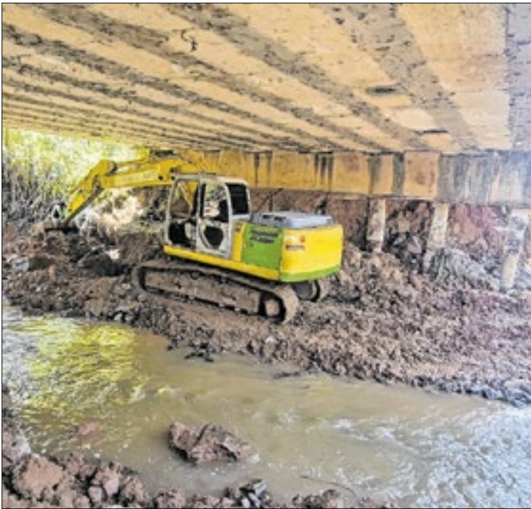
Ponte da SP-073 foi interditada no dia 5 de fevereiro
