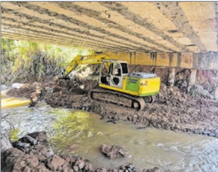
Ponte da rodovia foi interditada há mais de um mês e meio
