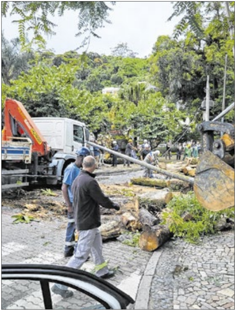
Árvore atingiu a fiação e afetou o fornecimento de energia
