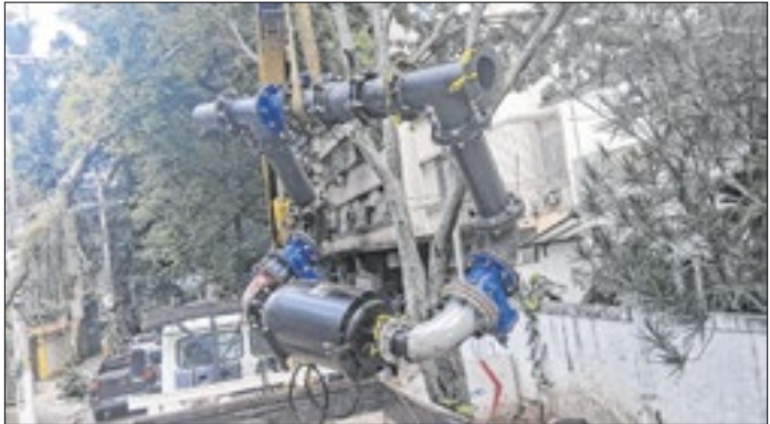
Equipamento melhora fornecimento de água no Humaitá
