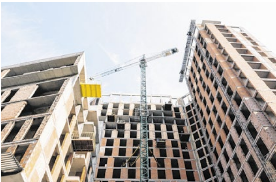
Ao menos 34 obras foram interrompidas na capital paulista
