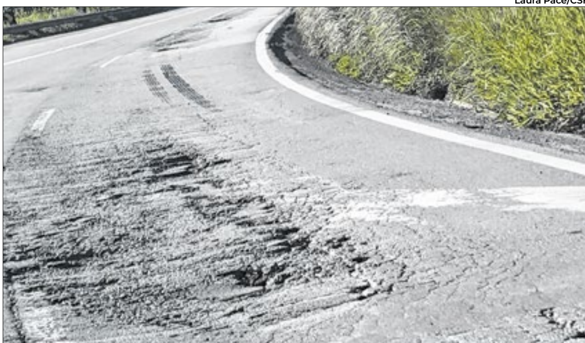
Durante o trecho, motorista precisa se atentar frequentemente com buracos
