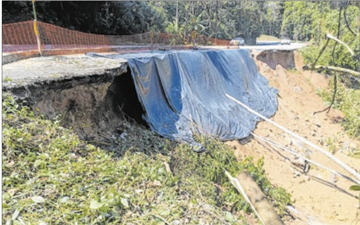
O documento aponta alto grau de risco para deslizamentos
