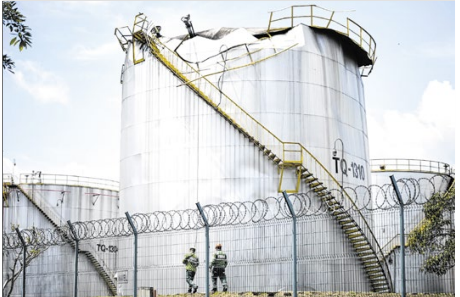
Acidente ocorreu durante uma manutenção com solda no tanque de combustível da Vibra
