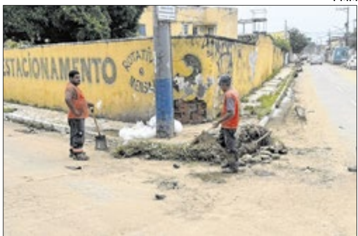
Foram registrados desabamentos e desbarrancamentos
