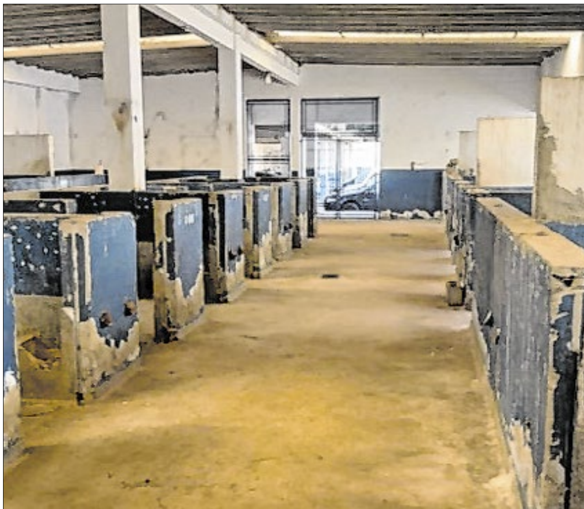
Departamento já foi vistoriado pelo STMC, que constatou precariedades por fotos e vídeos Câmara Municipal de Campinas
