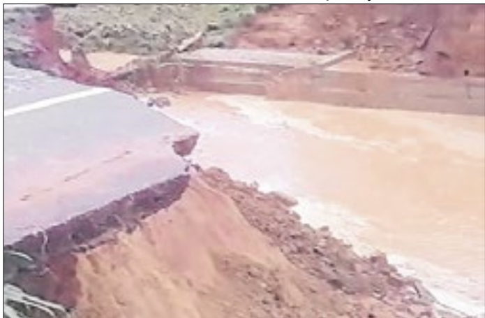
Alagamentos, deslizamentos e muitos prejuízos registrados
