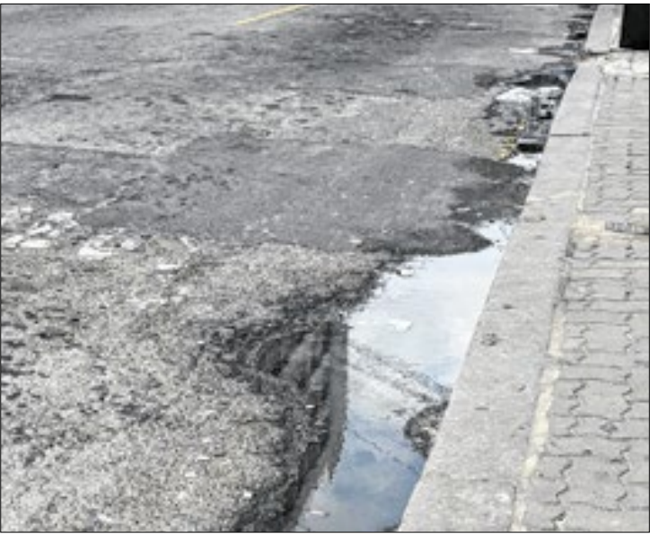
Local já apresentou vazamentos em outubro do ano passado
