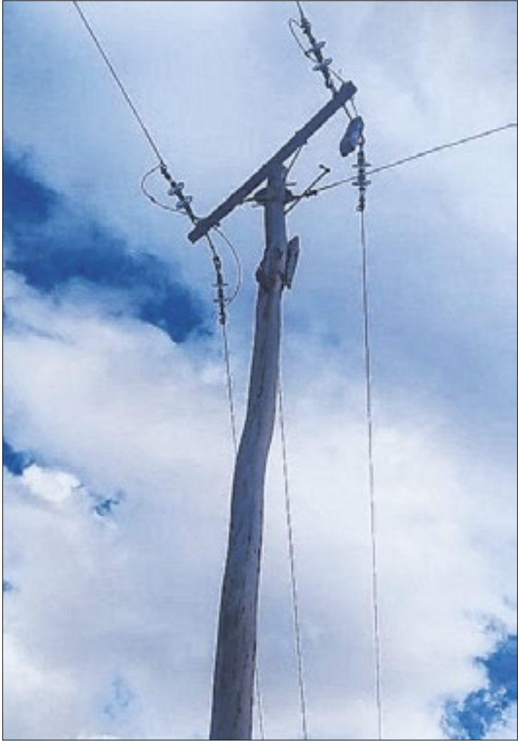
Além da falta de luz, existem problemas estruturais nos postes
