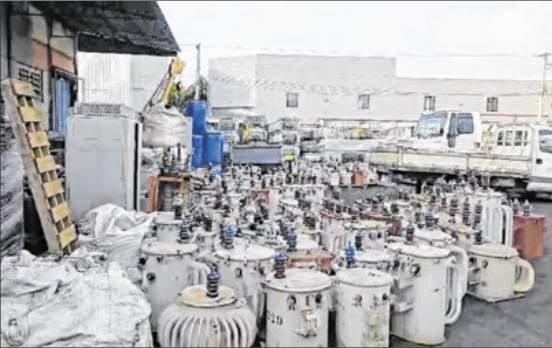
Galpão onde os transformadores de energia elétrica eram postos pelos criminosos
